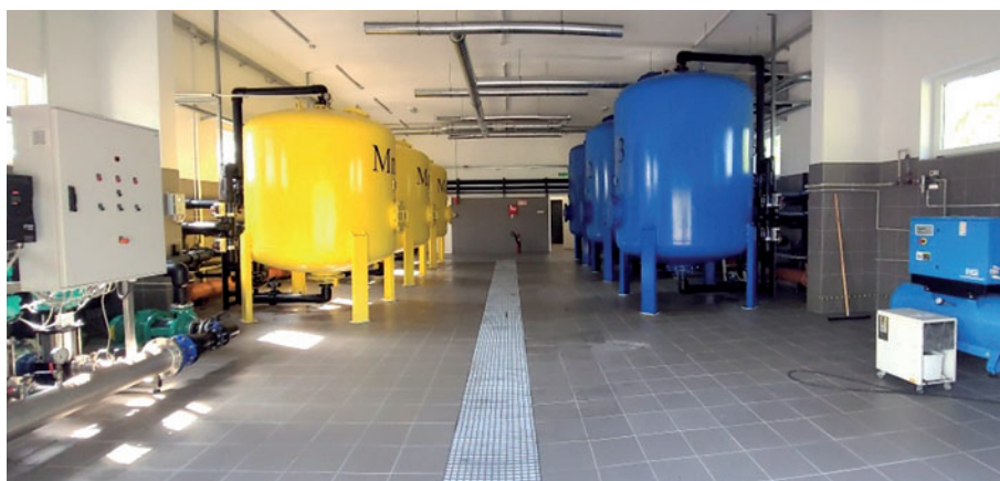
Hala filtrów na stacji uzdatniania wody
