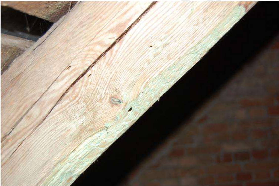
fot. 6. Otwory wylotowe w drewnie krokwi.
