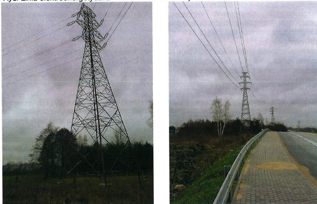
Rys. Linia elektroenergetyczna 110 kV na obszarze opracowania.
