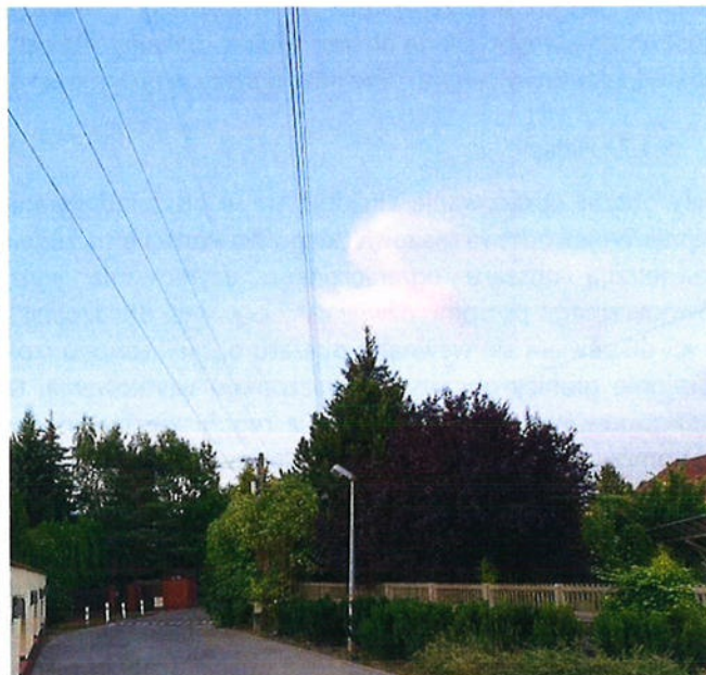
Fot. 3 Linia elektroenergetyczna 220 kV (źródło: „Opracowanie ekofizjograficzne (...)”)
