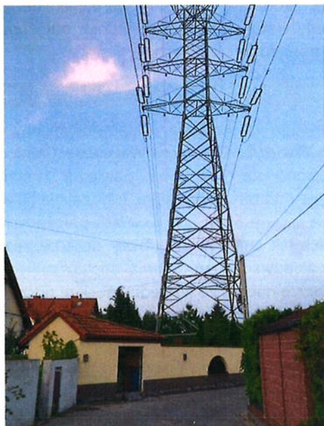
Fot. 2 Linia elektroenergetyczna 220 kV (źródło: „Opracowanie ekofizjograficzne (...)”)
